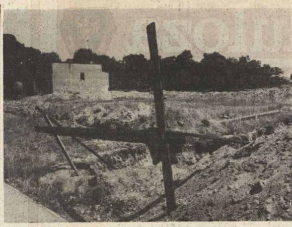
Wykopki pod nowe budynki mieszkalne dla „Celulozy” przy ul. Boh. Stalingradu w Kostrzynie.
